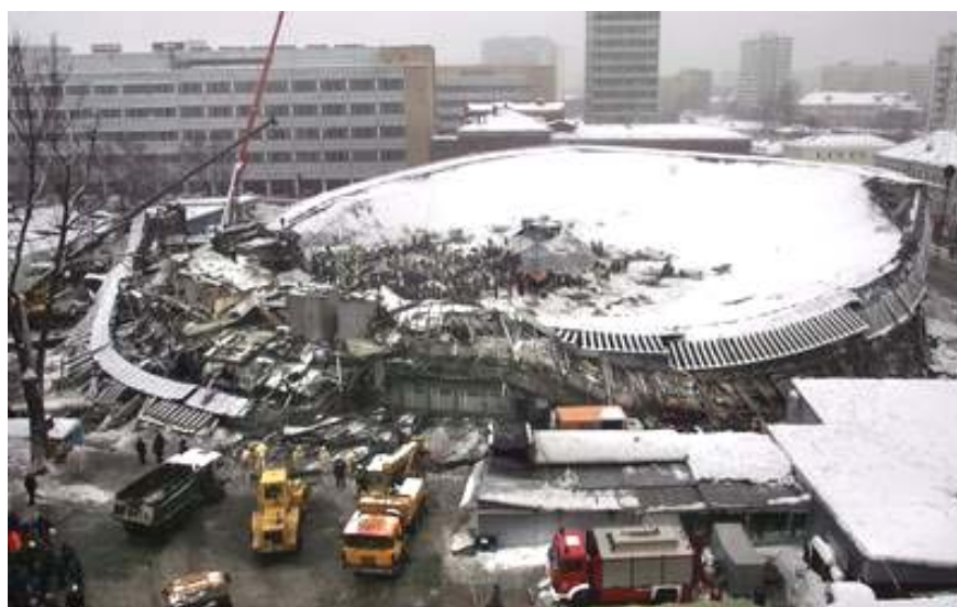
Рис. 1. Здание Басманного рынка после обрушения
