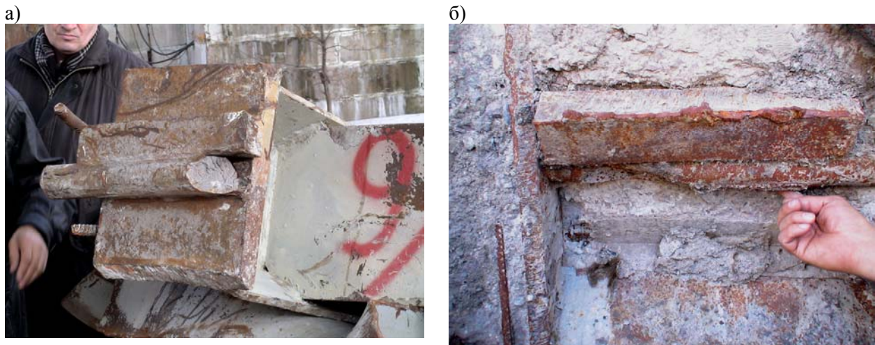
Рис. 9. Разрушение узлов сопряжения колонны с железобетонным кольцом: а) – разрушение по сечению «оси»; б) – срез сварных швов и выкол части «оси»
